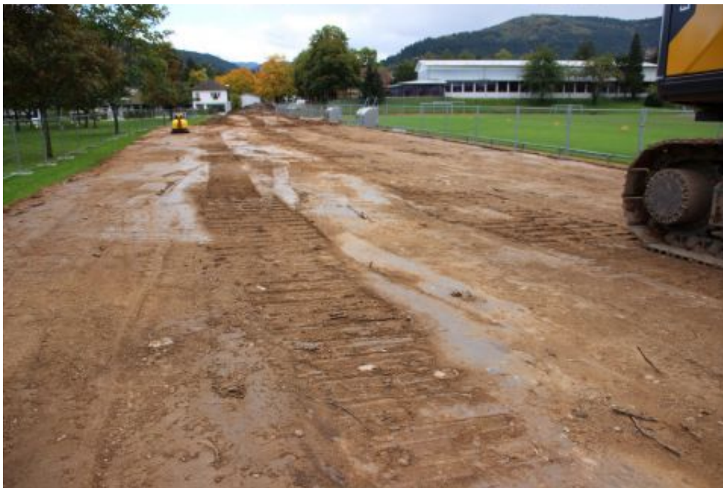
Ein kleiner Erdwall zwischen Stadion und Schwimmbad wird zur breiten Autobahn - für LKW und Bagger, als Transportstraße
